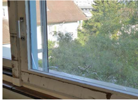
Die Fenster entsprechen den energetischen Vorschriften in keiner Weise mehr.
