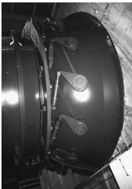
Das Gehäuse einer Kaplanturbine tief unter dem Niveau des Wasserspiegels.
