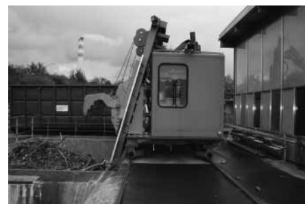
Die Rechenreinigungsmaschine funktioniert automatisch.
